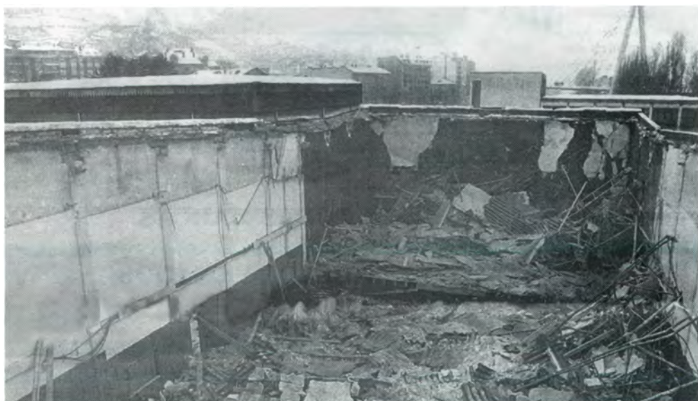
El Teatro langreo después de derrumbarse el tejado
