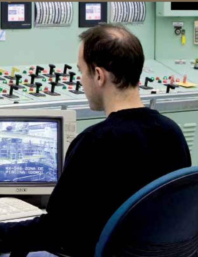
Sala de control de la central nuclear de Santa María de Garoña.
