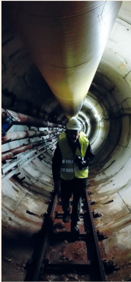
Túnel submarino entre La Salve, de Laredo, y Santoña (Cantabria), para el trasvase de aguas residuales.
